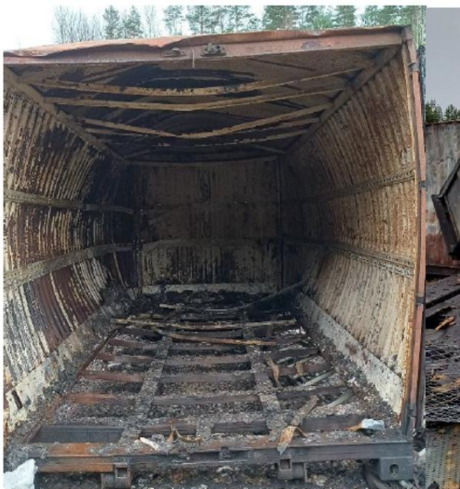
Kuva 3 Kontit kärsivät merkittäviä vaurioita. Lähde TUKES 2
